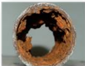
Пример коррозии стальной трубы без внутреннего защитного покрытия
